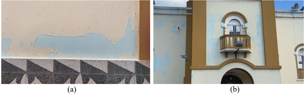
Figura 9 – Aspectos visuais do descascamento nas fachadas da edificação – (a) aspectos visuais na fachada posterior; (b) aspectos visuais na fachada frontal
