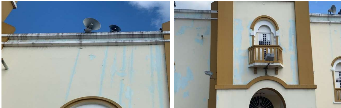
Figura 14 - Aspectos visuais do bolor na fachada frontal da edificação – (a) presença do bolor na parte superior direita da fachada frontal; (b) perspectiva da presença do bolor nas partes superior esquerda e superior direita da edificação
