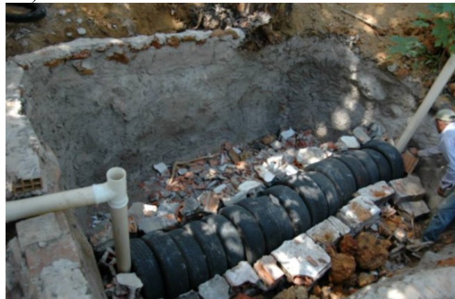
Figura 9 – Construção da Tecnologia Social de Saneamento Círculo de Bananeiras (Espírito Santo e Brasília)
