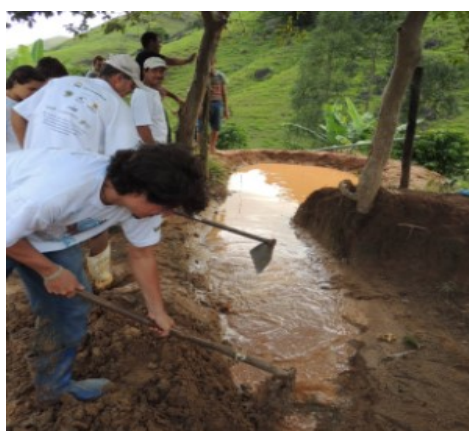
Figura 8 – Construção de reservatório para captação de água da Tecnologia Social Plantando Águas (Minas Gerais e Espírito Santo)
