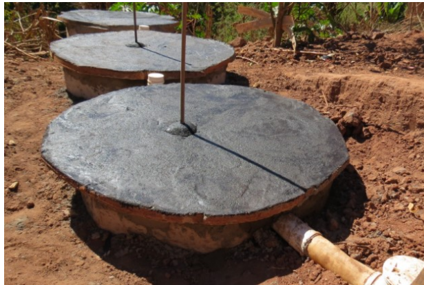
Figura 11 – Tecnologia Social Fossa Séptica Biodigestora de Placas em sua forma final (Minas Gerais)
