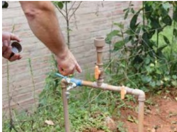
Figura 6 – Estrutura da Tecnologia Social Clorador acoplada no encanamento hidráulico (São Paulo)
