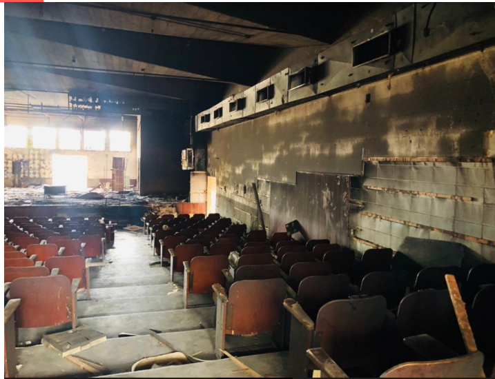
Figura 8: Incendio en la UDO
