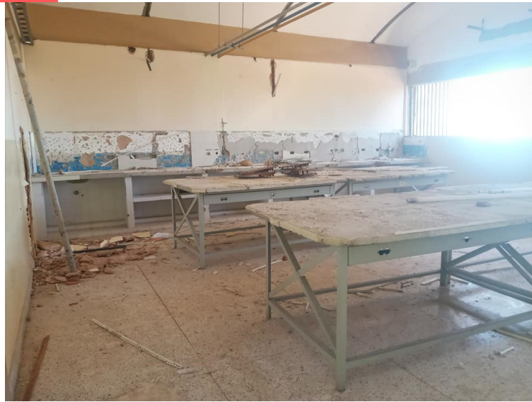
Figura 12: Destrucción en la UDO
