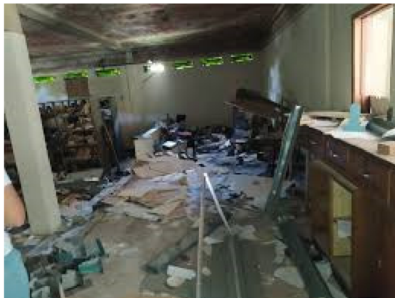
Figura 19: Destrucción en la UDO. Tomada de: https://encrypted-
