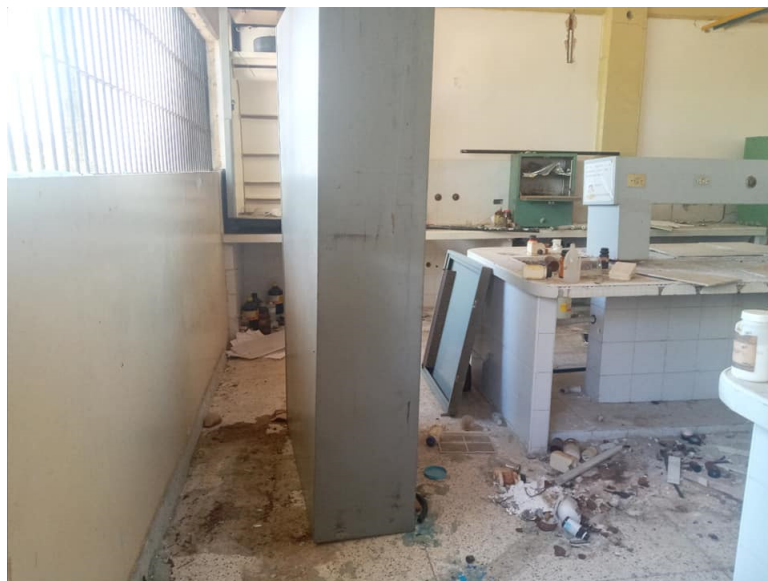
Figura 15: Destrucción en la UDO
