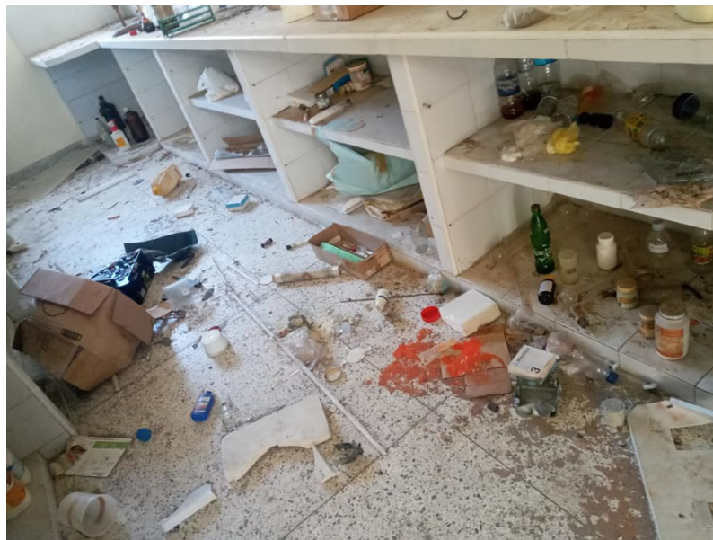
Figura 17: Destrucción en la UDO
