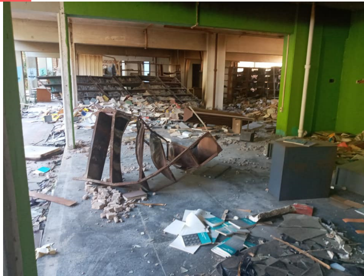
Figura 10: Destrucción en la UDO
