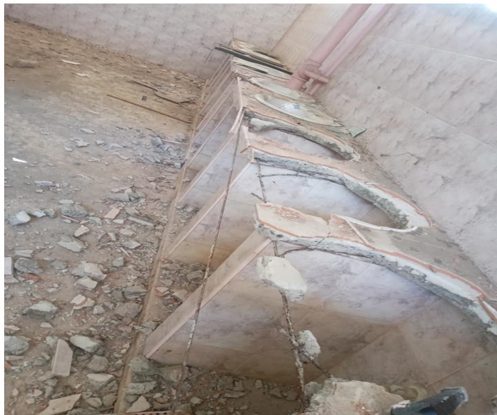
Figura 11: Destrucción en la UDO
