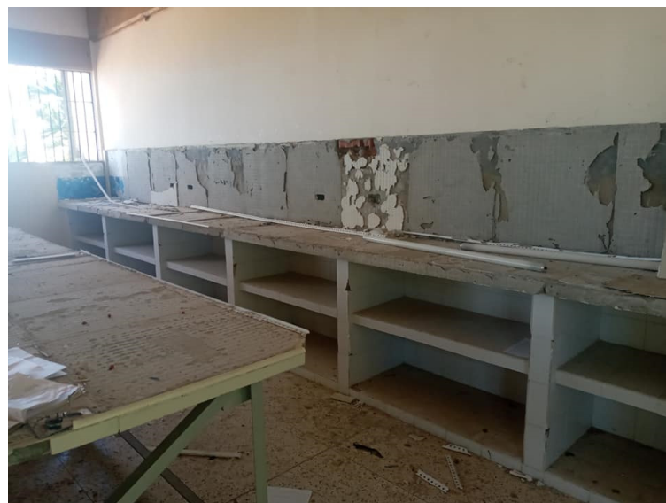
Figura 13: Destrucción en la UDO
