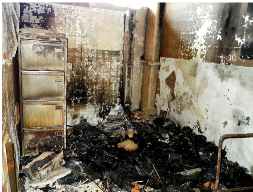
Figura 5: Incendio en la UDO
