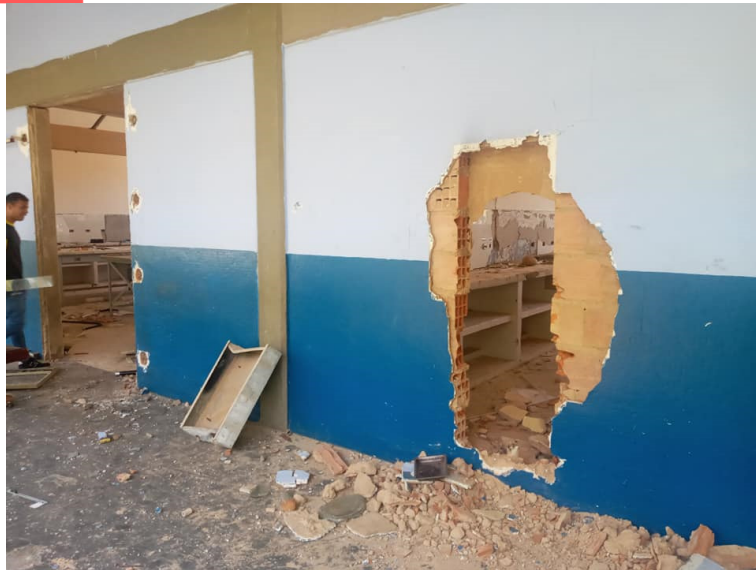
Figura 14: Destrucción en la UDO
