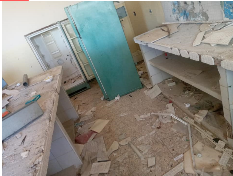
Figura 16: Destrucción en la UDO
